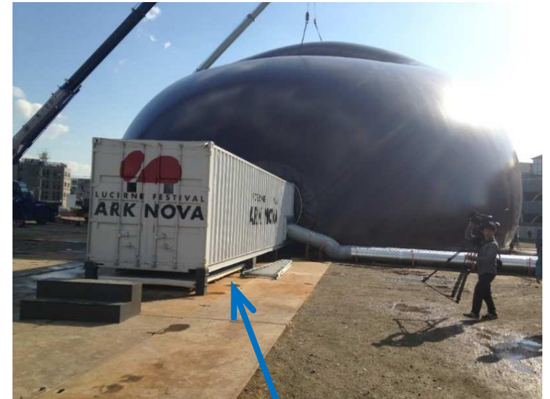
搬入口 兼 送風口 兼 輸送用コンテナ
