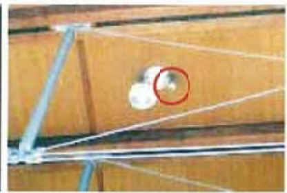
(c)衝突による照明器具の破損脱落
