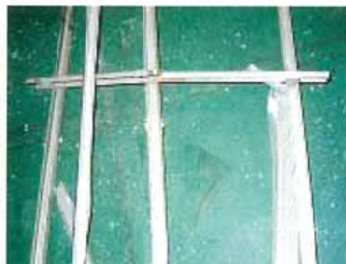
(h)野縁受けごと脱落している例
