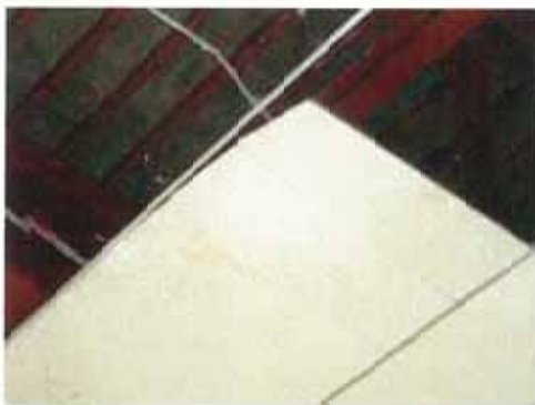
(g)Hバーからの天井材の外れ
