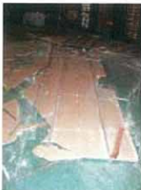
(g)散乱する天井材とフック金物
