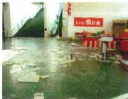
(d)福岡県西方沖地震後の公共ホール 壁面仕上げの脱落
