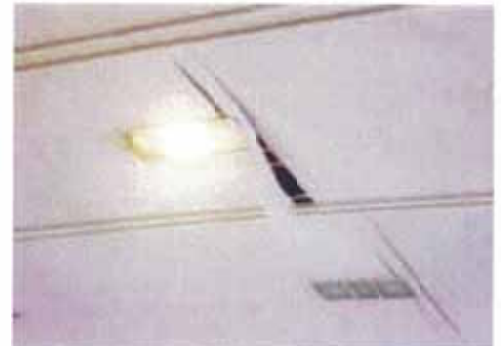
(e)福岡県西方沖地震後の公共プール
