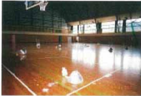
(d) 照明機器の脱落
