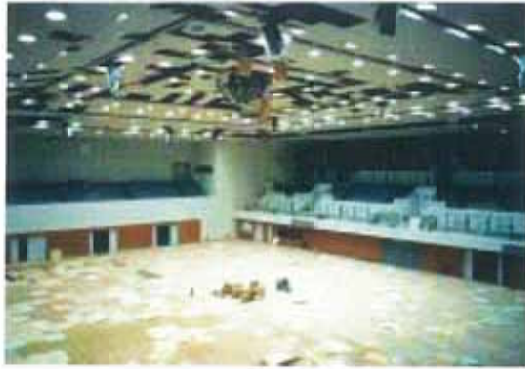
(a)天井材や空調吹き出し口の落下
