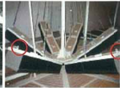
(f) スピーカー吊り材の外れ
