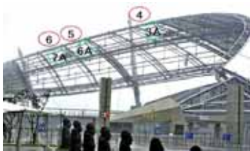
Fig. 2. 台風 RUSA による 2次破損
