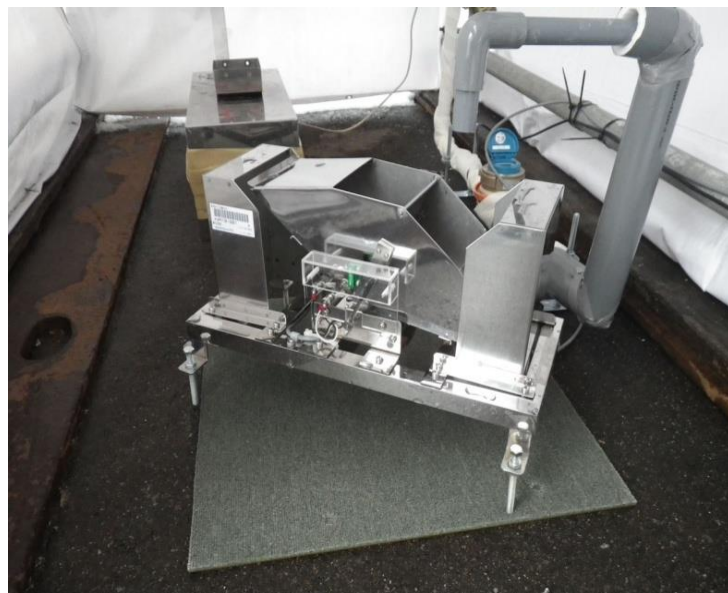
流量計測システム(転倒マス流量計と水道メーター)
