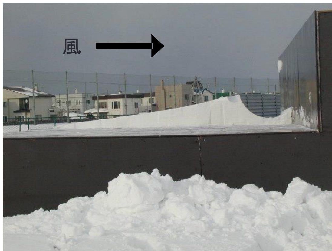
階段屋根下段の吹きだまり状況
