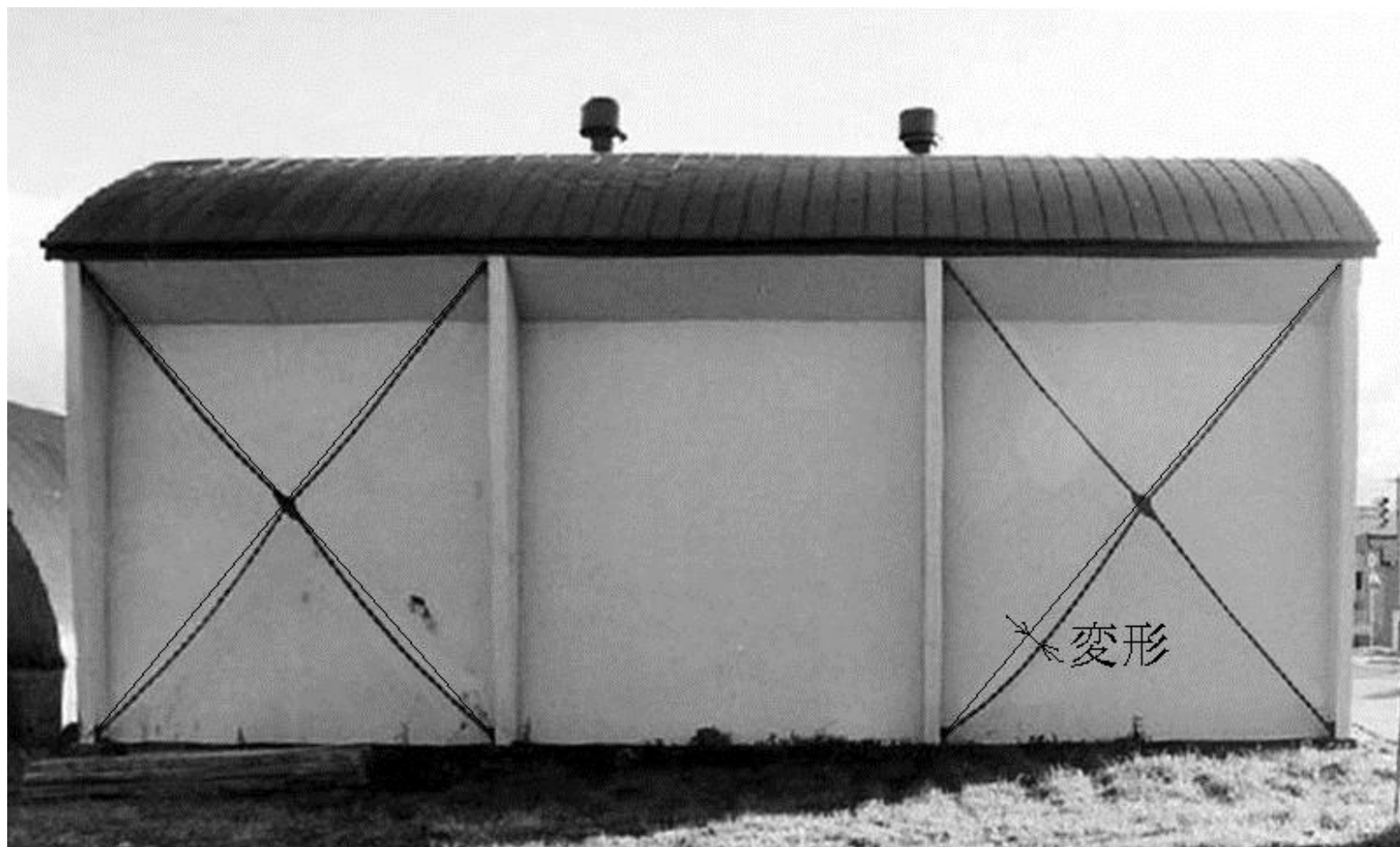
沈降力によるブレースの変形例
