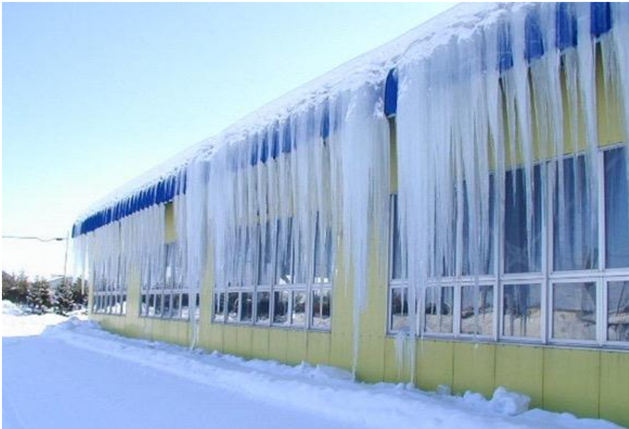
倉庫建築物の屋根に形成したつらら
