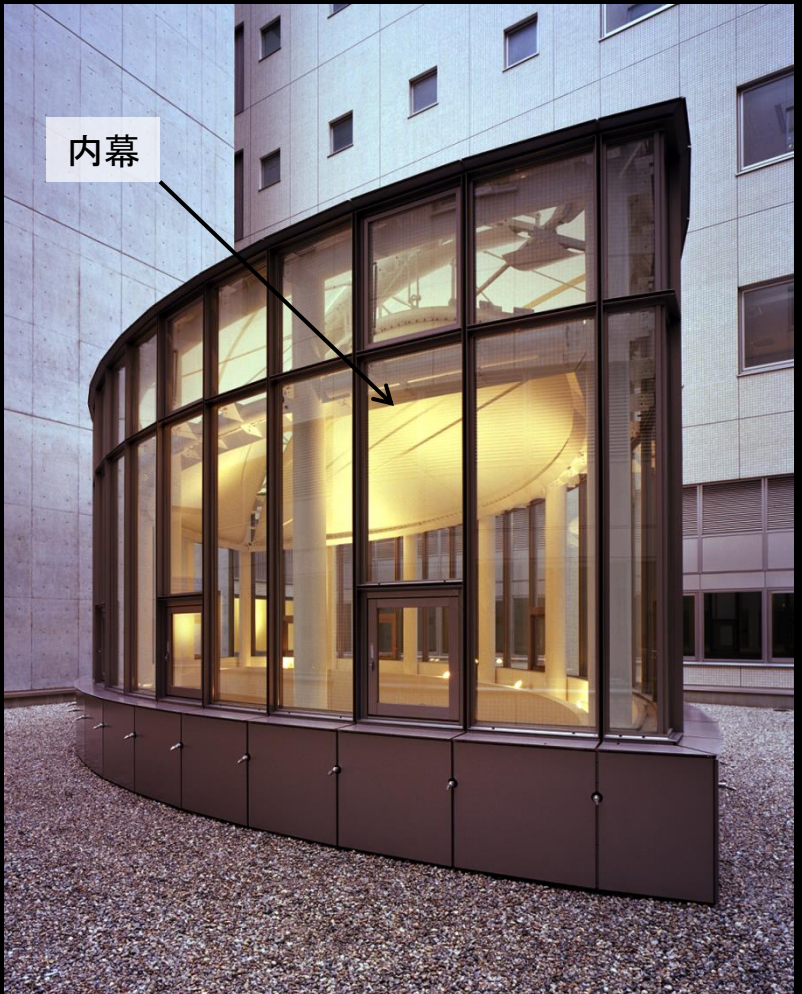
内幕を結露ドレン受けとして利用
