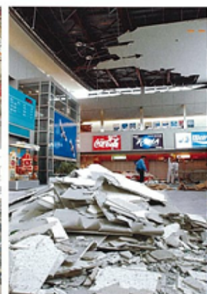
釧路空港ターミナル天井災害写真(毎日新聞社)
