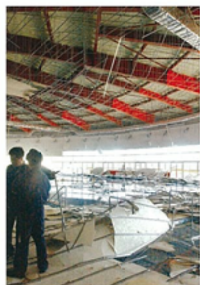
仙台市内プール天井災害写真(毎日新聞社)
