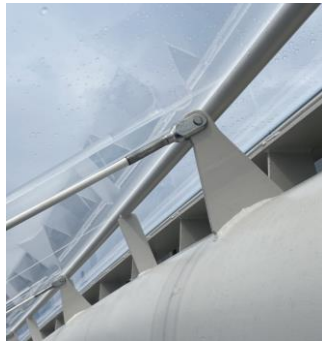
写真4 水上側ケーブル端部
