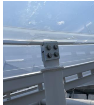
写真5 ケーブル中間部
